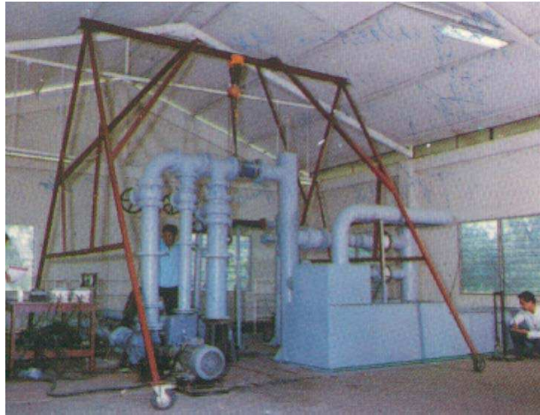
Gambar 3. Instalasi pengujian pompa di BBP Mektan, Serpong
