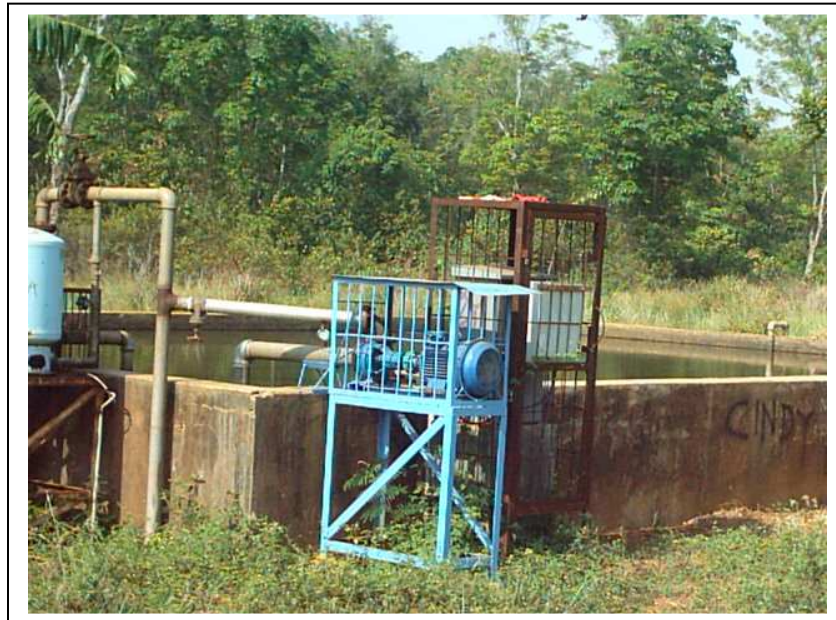
Gambar 5. Instalasi pompa penguat menggunakan prototipe pompa AP-S100.
